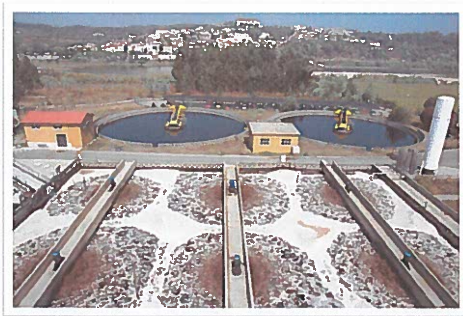
Figura 3: Estação de Tratamento de Águas Residuais - Tratamento aeróbio
